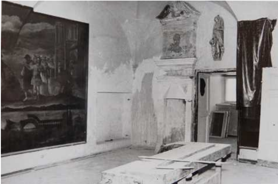
Fot. 10. Sala Sądowa, w czasie konserwacji 1982 r. Kominek w czasie usuwania farby. Usunięto piec kaflowy. Fot. ze zbiorów Archiwum Muzeum Miasta Chełmna.
