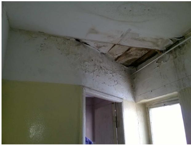
Fot.13. Wykwity na ścianie i suficie – I piętro
