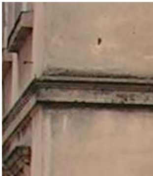
Zdjęcie.6 - elementy podlegające naprawie
