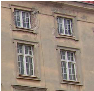
Zdjęcie.7 - elementy podlegające naprawie
