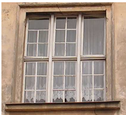
Zdjęcie.3 - elementy podlegające naprawie
