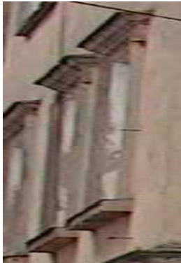
Zdjęcie.4 - elementy podlegające naprawie
