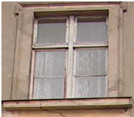
Zdjęcie.1 - elementy podlegające naprawie
