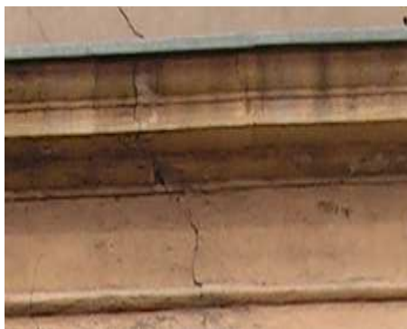
Zdjęcie.2 - elementy podlegające naprawie
