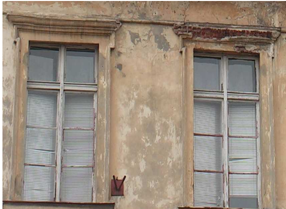
Zdjęcie.5 - elementy podlegające naprawie
