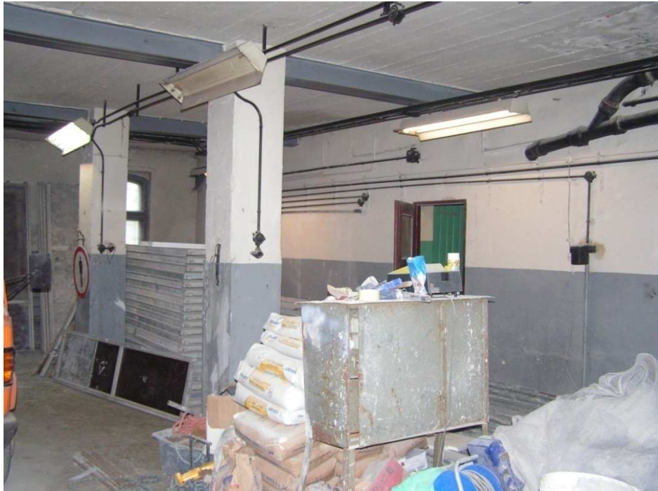
Chełmno, ul. Kamionka 3, Wnętrze budynku dwukondygnacyjnego, przeznaczone do adaptacji, widoczne zacieki na stropie spowodowane nieszczelnościami kanalizacji.
