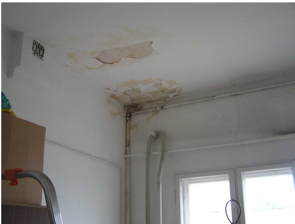
Chełmno, ul. Kamionka 3, Wnętrze budynku dwukondygnacyjnego, jedno z pomieszczeń - widoczne zacieki na suficie.
