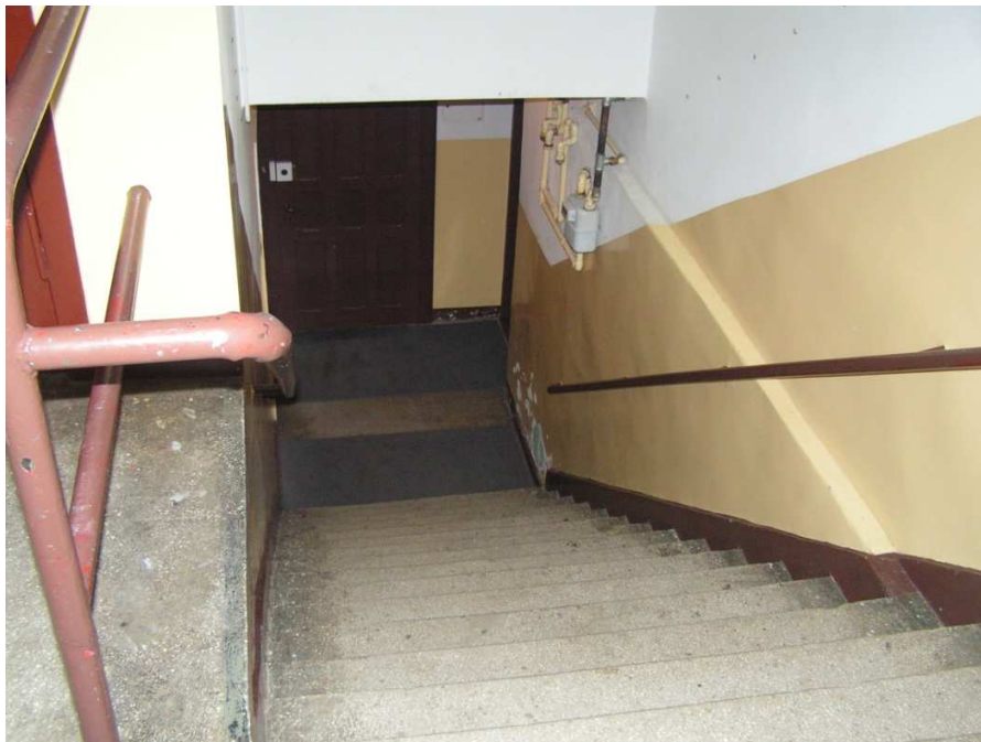
Chełmno, ul. Kamionka 3, Wnętrze budynku dwukondygnacyjnego, komunikacja - widoczne zawilgocenia ścian.
