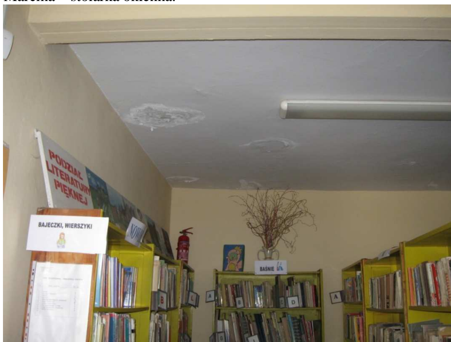
Chełmno, ul. 22 Stycznia, Biblioteka Szkoły Podstawowej nr 2 – widok wnętrza i uszkodzeń sufitu spowodowanych zaciekami wody opadowej.
