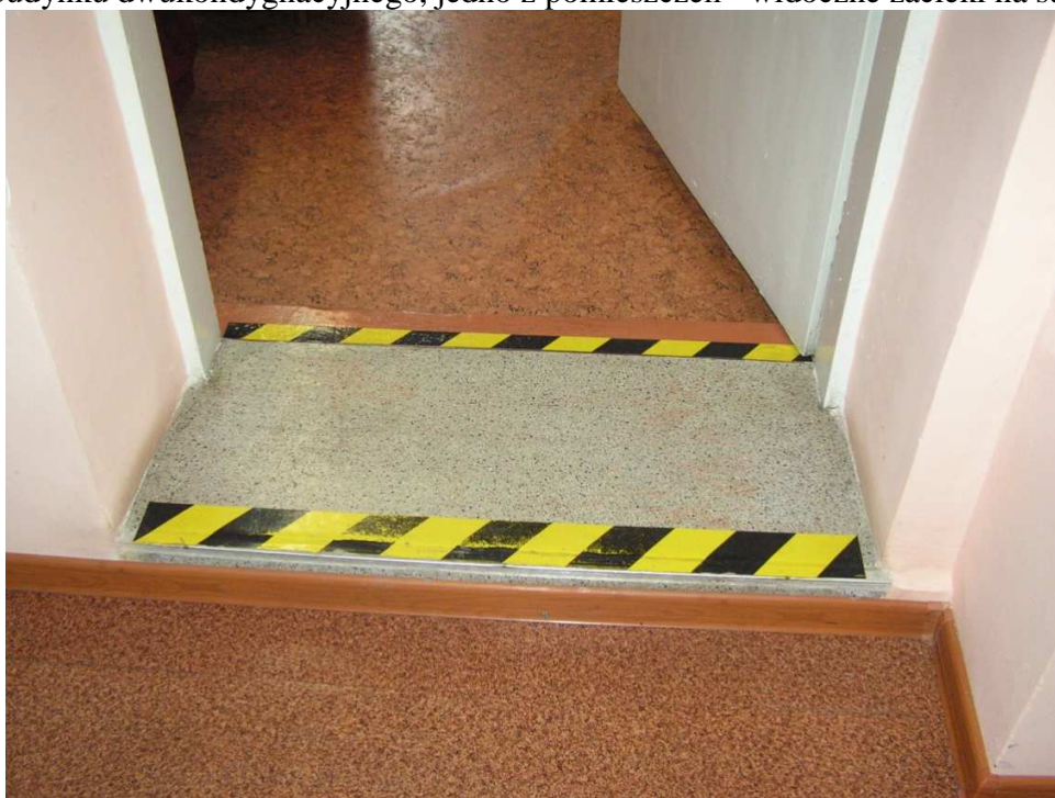
Chełmno, ul. Kamionka 3, Wnętrze budynku dwukondygnacyjnego, niebezpieczne progi pomiędzy pomieszczeniami.
