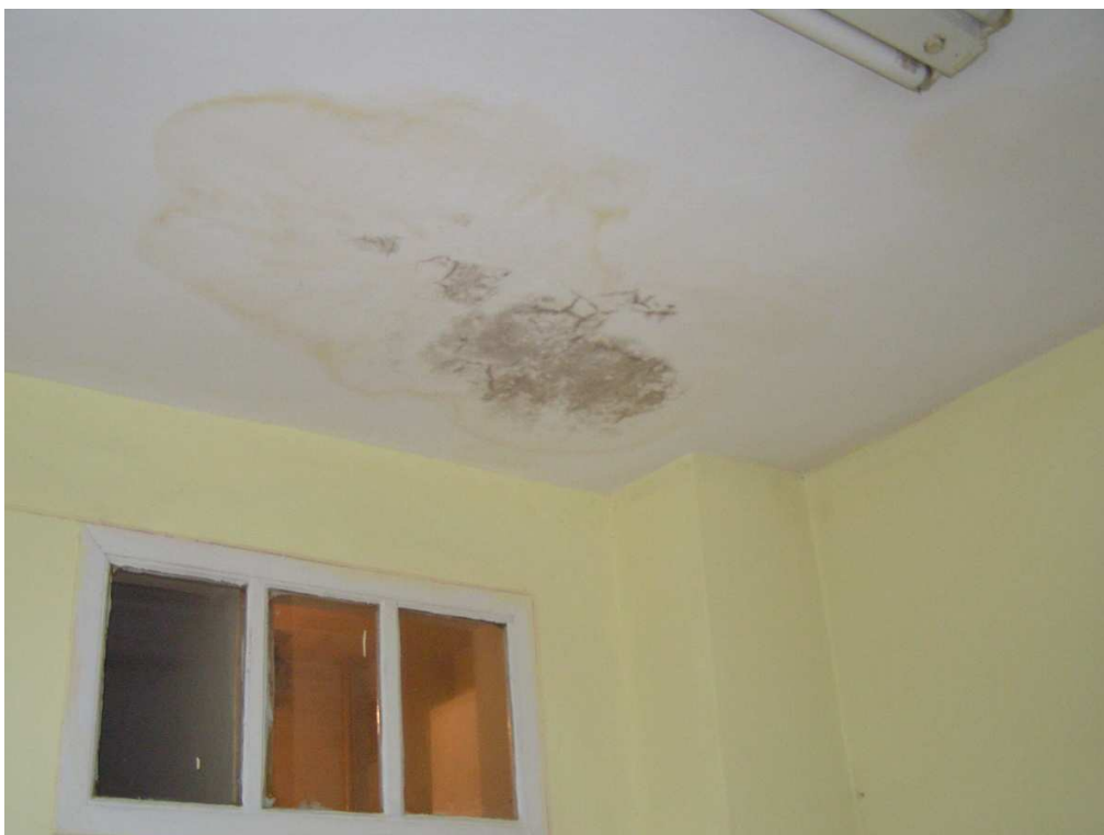
Chełmno, ul. Kamionka 3, Wnętrze budynku trzykondygnacyjnego, komunikacja - widoczne zawilgocenia ścian.
