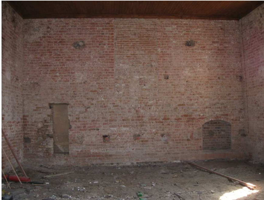
Chełmno (przy ciągu pieszym pomiędzy ul. Toruńską a 22 Stycznia) Kaplica św. Marcina – wnętrze, widoczny brak posadzki i stan ścian.
