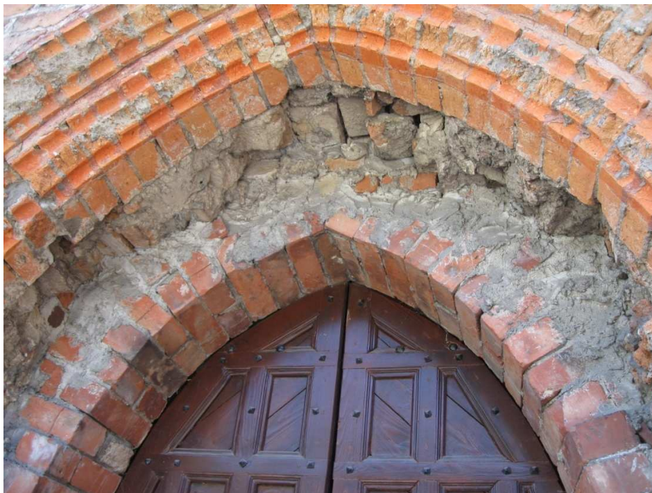
Chełmno (przy ciągu pieszym pomiędzy ul. Toruńską a 22 Stycznia) Kaplica św. Marcina – portal wejściowy, widoczne ubytki cegieł i stan struktury wnętrza muru.
